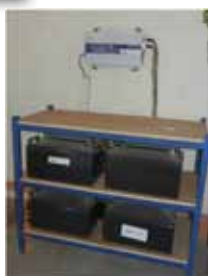
Les batteries pour stocker l'électricité
