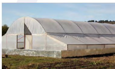
Mur de protection des serres contre les rongeurs, porteurs des hantavirus
